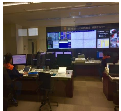
消防指令センター
